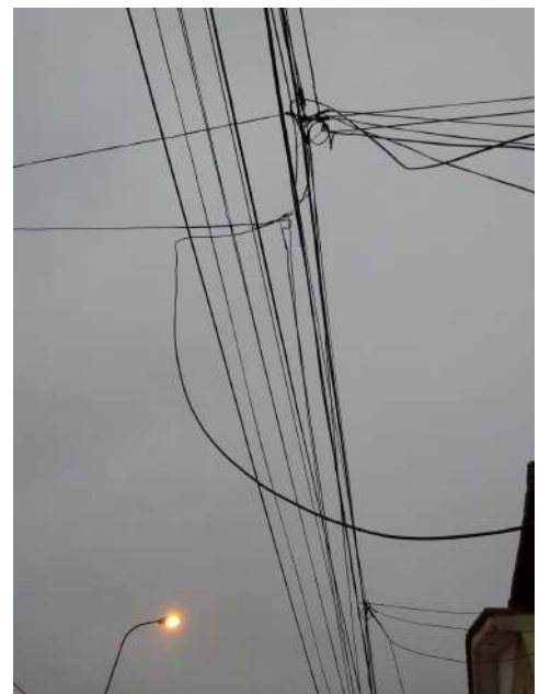
Fotografía de cables de luz, 2019
